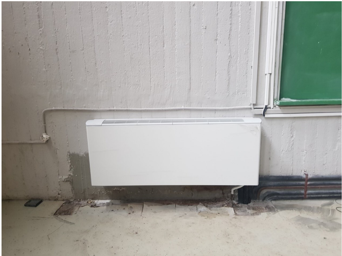
Τα νέα σώματα θέρμανσης στο Κεντρικό Αμφιθέατρο.
